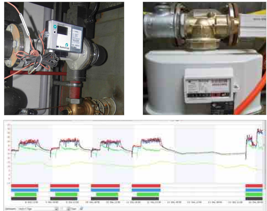
Abb. 4.11: Wärmemengenzähler (links), Gaszähler (rechts), Datendarstellung über Webbrowser (unten)
